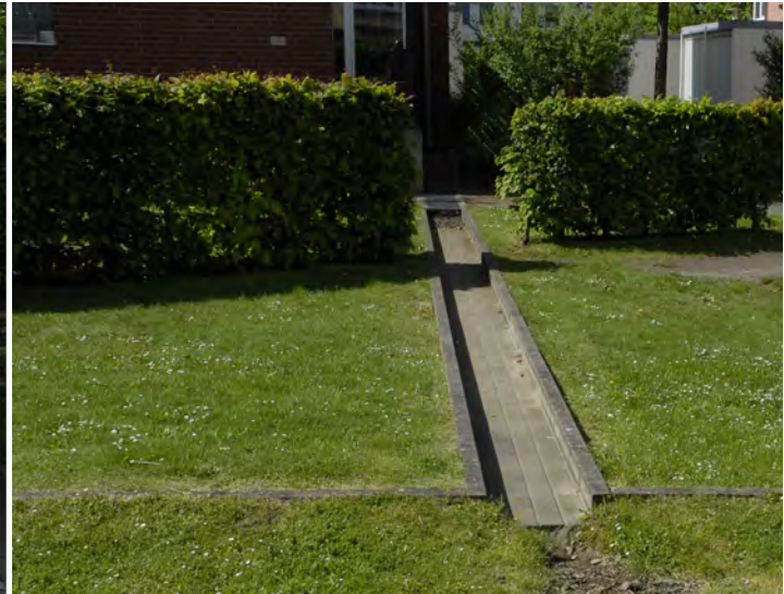
❖ Abb. 27 Sammelrinne zur Ableitung auf Rasenfläche
