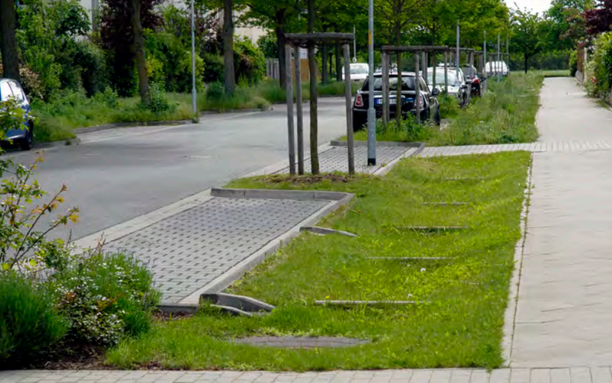
Abb. 22 Muldenkaskaden zur Versickerung von Straßenabflüssen
